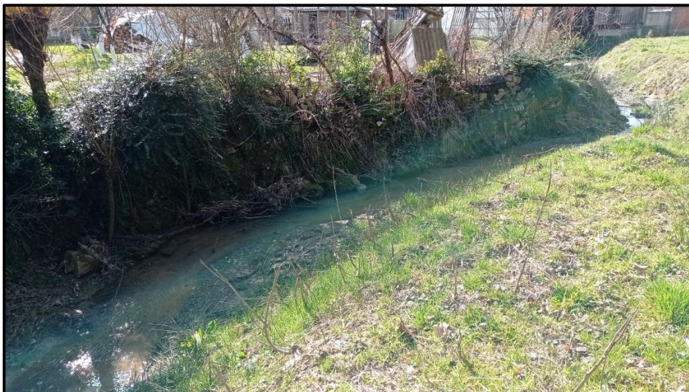
Slika 2.1-3. Neodržavana i zarasla obala u uzvodnom dijelu predmetne dionice
